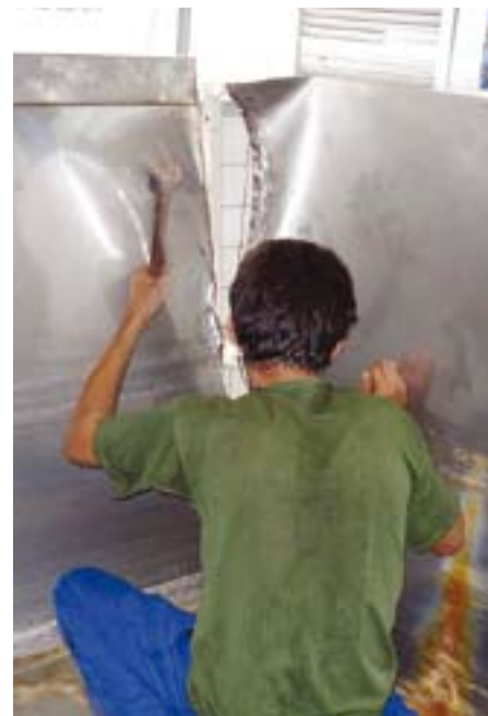
Cubas destruídas a marretadas: descaso
